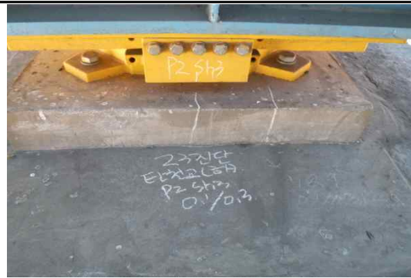
받침물탈 균열(cw=0.1mm) (하행 P2 Sh3)
