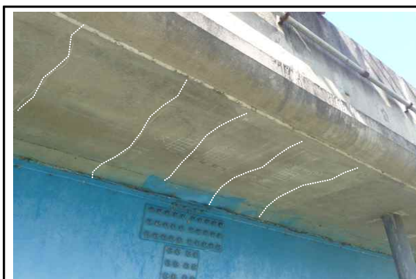
균열(cw=0.2mm) (상행 S4 RC)
