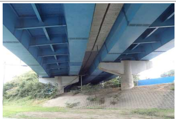
점검시설 미설치 현황 (P1)
