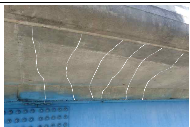
균열(cw=0.1mm) (하행 S3 LC)
