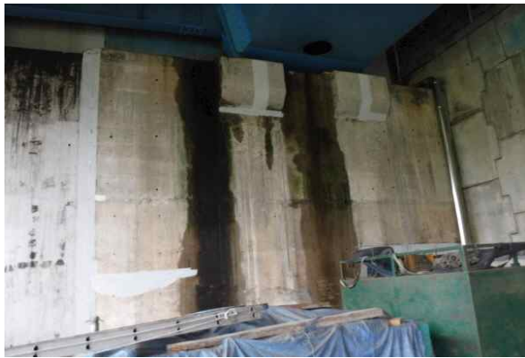
벽체 누수흔적 및 오염 (상행 A2)
