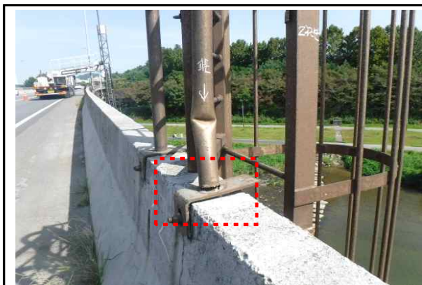
점검시설 출입문 플레이트파손 (상행 P2)
