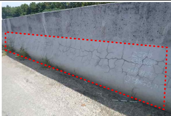
방호벽 망상균열(cw=0.2mm) (상행 S2)
