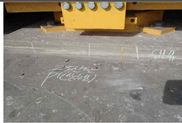
받침물탈 균열(cw=0.1mm) (상행 P1 Sh8)
