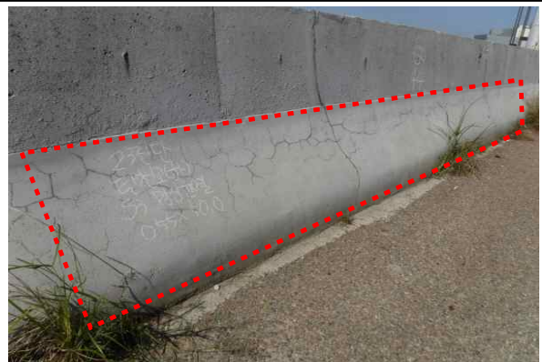
방호벽 망상균열(cw=0.2mm) (하행 S5)
