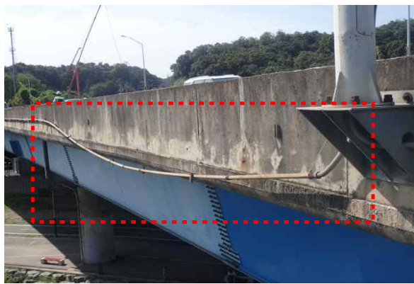
지장물 고정앵커 탈락 (상행 S3)
