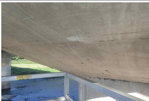
코핑 균열(cw=0.3mm) (하행 P2)
