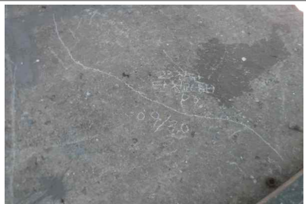
코핑 균열(cw=0.9mm) (하행 P3)
