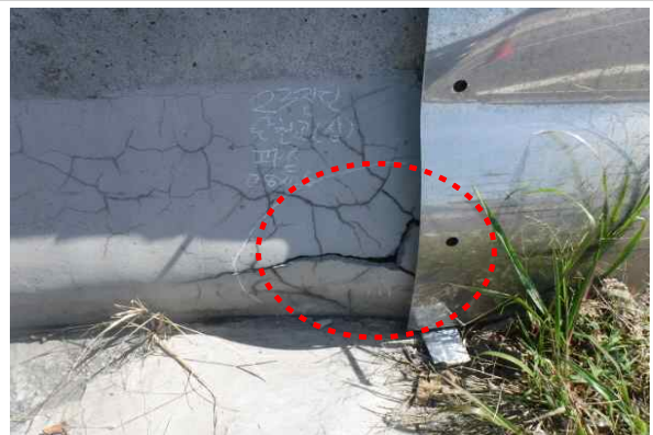
방호벽 파손 (상행 S5)
