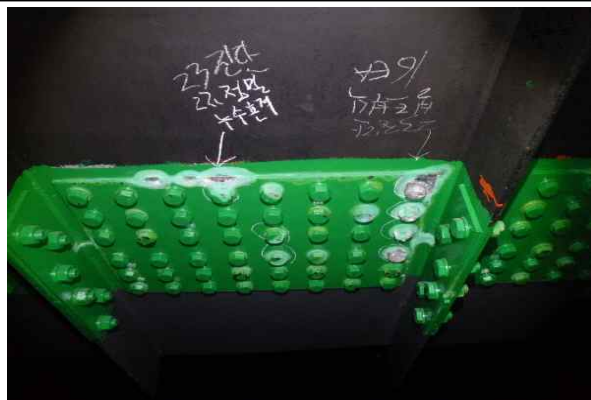
내부 누수흔적 및 볼트부식 (상행 S5 G3 UF)
